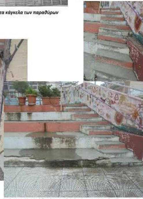
Εικόνα 12,13,14. Φθορές στο πλακόστρωτο και σκαλοπάτια των αύλειων χώρων.
